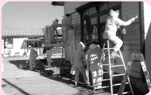
▲災害時においても、日常と変わらず、自分たちが できるボランティア活動を行いたい。 (福祉施設でのペンキ塗り作業の様子)
